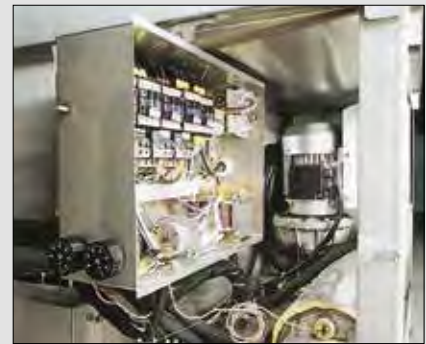
Cuadro eléctrico LP-67
