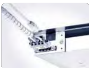
Conexión enchufe generador
